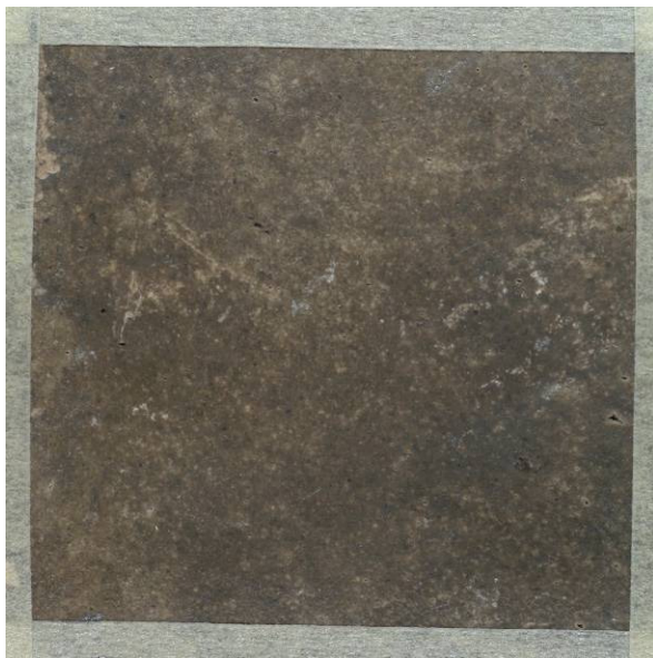
Testfläche 58 b I - Vorzustand
