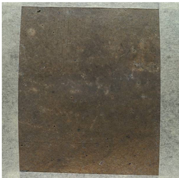
Testfläche 66 b I - Vorzustand
