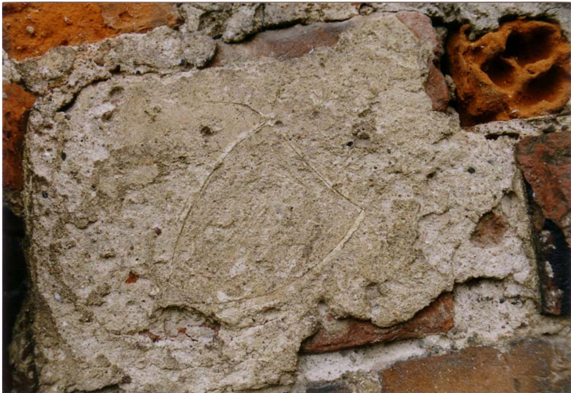
Abb. 2: Detail aus Abb. 1. Mittelalterlicher Putz mit Ritzungen (Wappenschild). Der Putz zeigt zahlreiche Abplatzungen.
