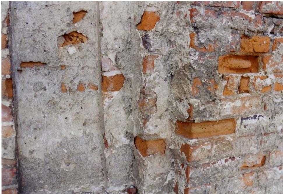
Abb. 4: Typische Putz- und Ziegelschäden an der N-Blende des Großen Fensters rechts des Alten Oberen Tores
