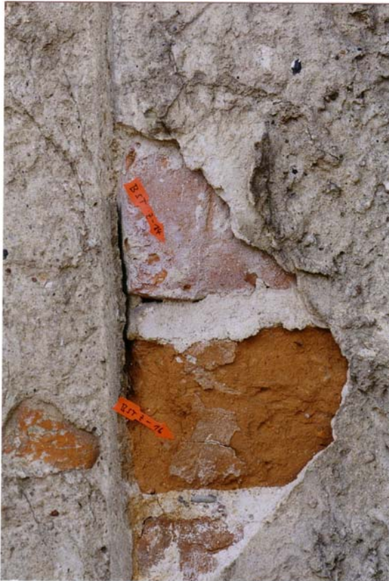
Abb. 44: Entnahmestellen der Probe Z-14 (weißer Belag auf der Ziegeloberfläche) und Z-16 (Ziegel- schale).
