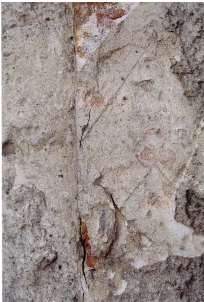
Abb. 5: Detail aus Abb. 4. Mittelalterlicher Putz mit Fassungs-resten und Ritzungen. Die Ornamente waren von einem dünnen Renaissance-putz überdeckt, dessen Reste im rechten unteren und rechten oberen Bildteil noch zu erkennen sind.
