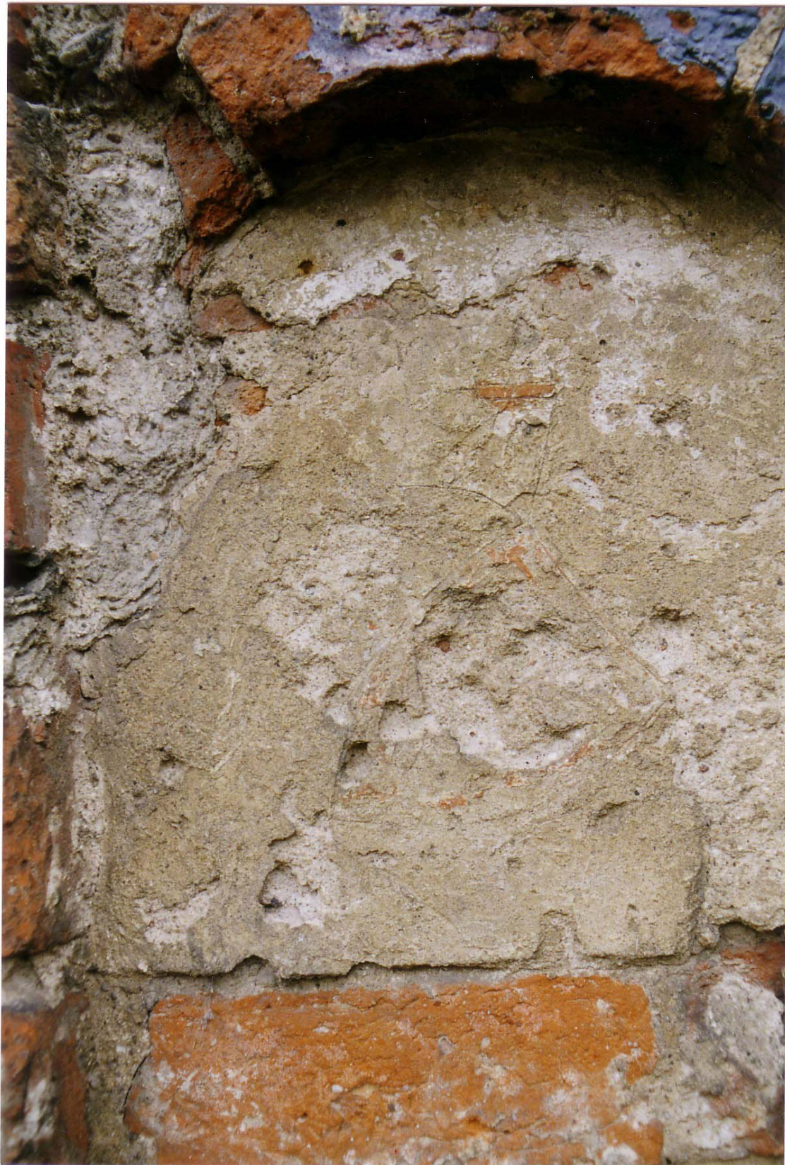
Abb. 3: Detail aus Abb. 1. Mittelalterlicher Putz unter einem glasierten Bogen mit Fassungsresten (rot) und Ritzungen. Es sind zahlreiche Abplatzungen vorhanden.
