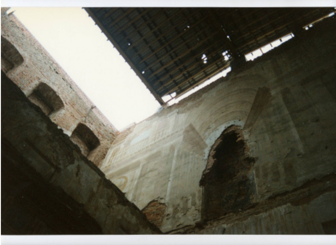
Abb. 4: Schloss Rossewitz: Zerstörung von Decken und Gewölben beim Einsturz des 2. Daches (1. Notdach), hier Blick aus der Eingangshalle unter dem Festsaal in den Festsaal
