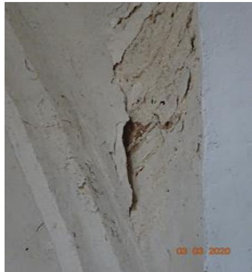
Abb. 6-3: Flächige Putzabplatzungen, Detail.
