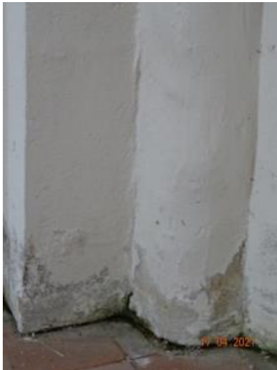
Abb. 3-6: Vergrünung im Sockelbereich.
