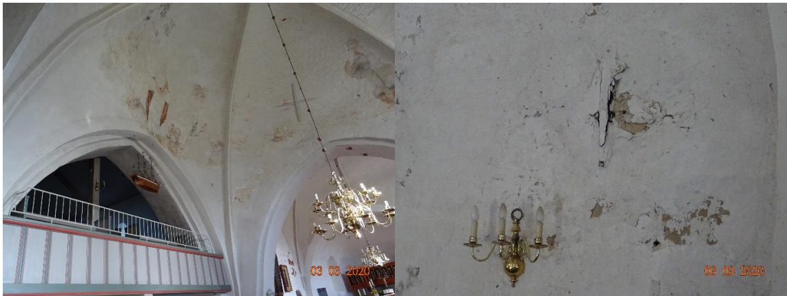
Abb. 6-1: abgeplatzter Putz in vielen Bereichen.
