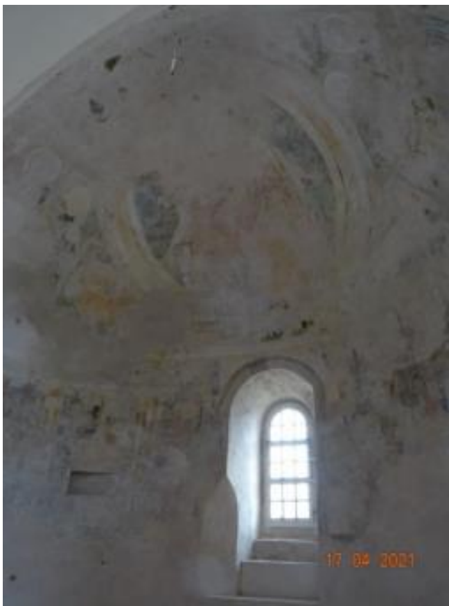
Abb. 3-19 Klimafühler im Gurtbogen.
