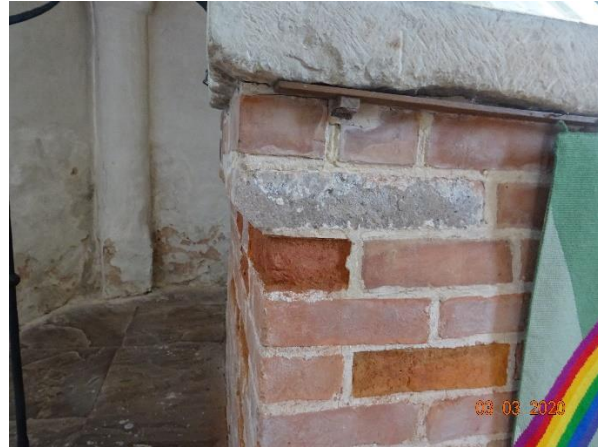
Abb. 6-5: Ausbrüche an Ziegeln, Detail.
