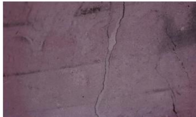
Abb. 3-15: Rissbereich unter LED-Beleuchtung, li. ohne, re. mit Besiedlung
