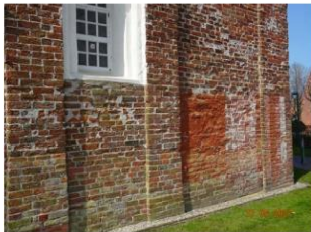
Abb. 3-2: Stark angegriffenes Ziegelmauerwerk mit weiteren testflächen für teils weniger auffällige Schlämmen.
