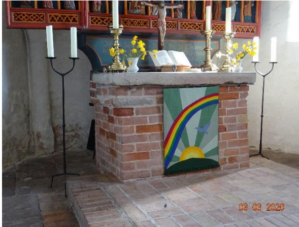
Abb. 6-4: Ausbrüche an Ziegeln.
