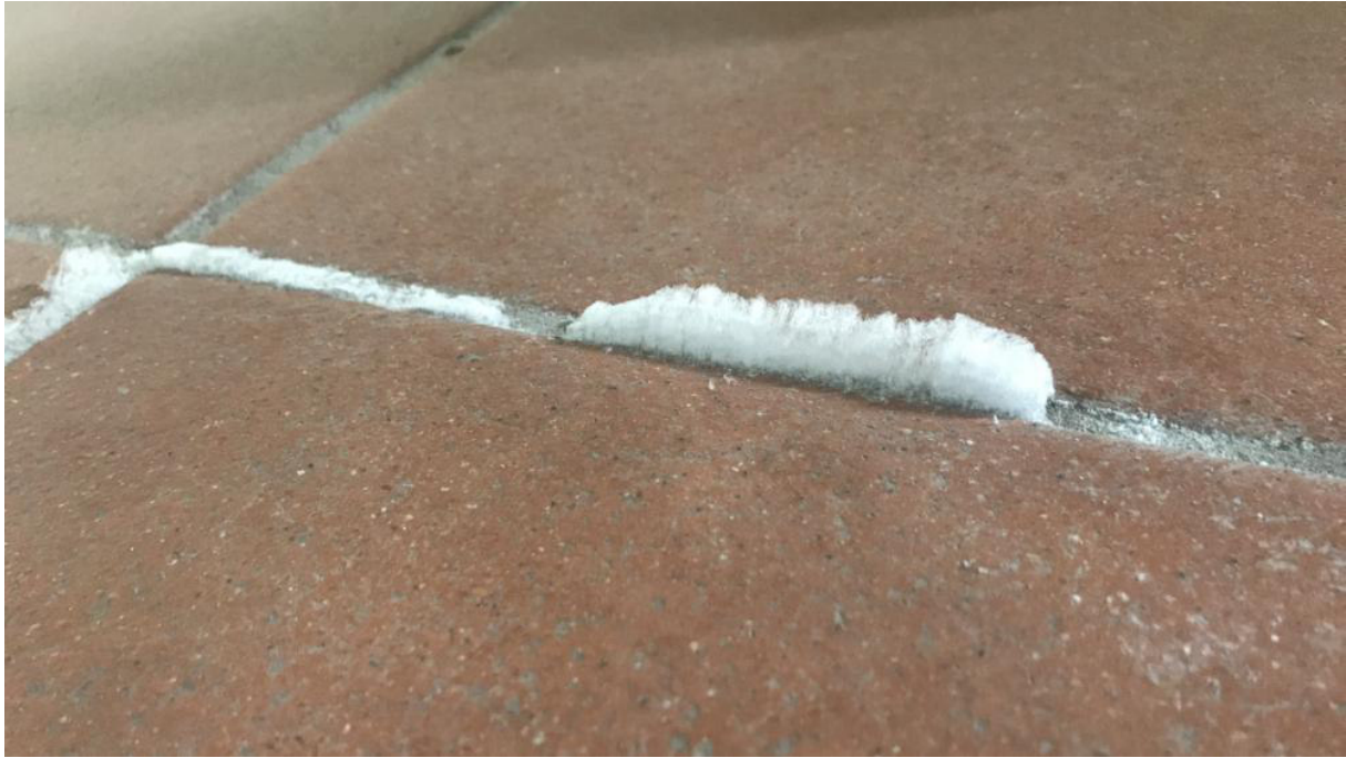
Abb. 4: Ausblühungen von Salzen auf den Fugen des Fußbodens der Kirche St. Vitus in Belum. Aufgrund der Austrocknung des Untergrundes blühen leicht lösliche Salze auf den porösen Fugen aus.
