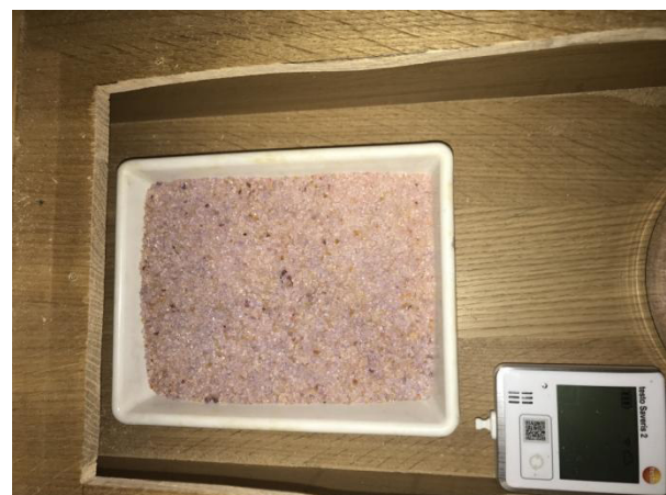
Abb. 14: geöffnete Wartungsklappe nach sechs Wochen. Das feuchte Silicagel hat die blaue Farbe verloren
